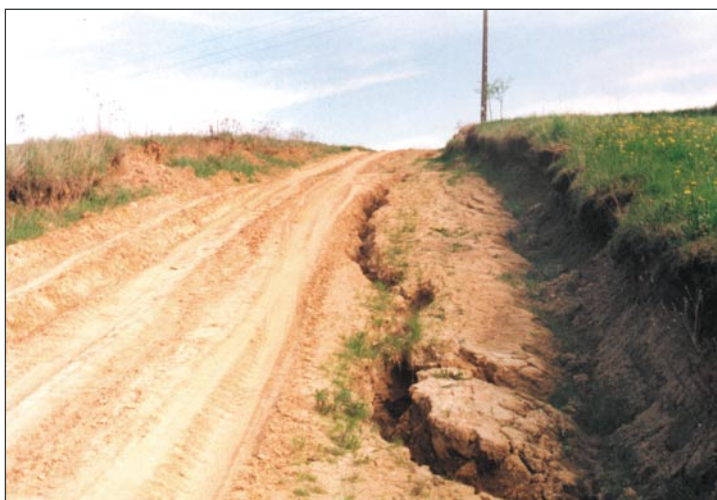
Fot. 6. Drogi w terenie erodowanym narażone są na częste uszkodzenia
